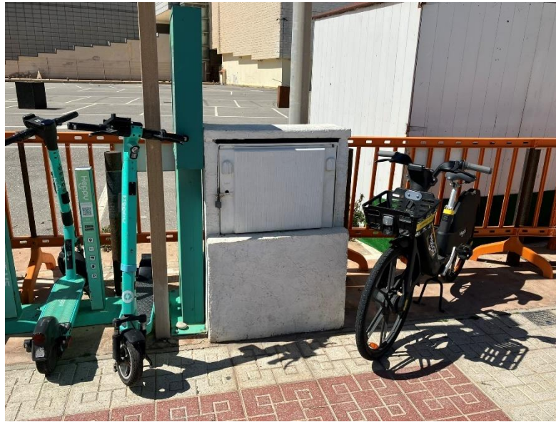
Foto 3.- Cuadro de mando existente
